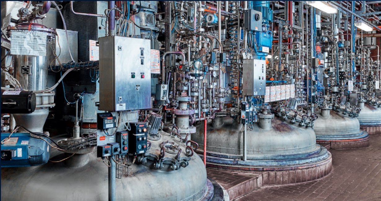
Pigmentherstellung: In riesigen Anlagen produziert Heubach Farben. Festo AX hilft, die PID-Regelung zu optimieren.
